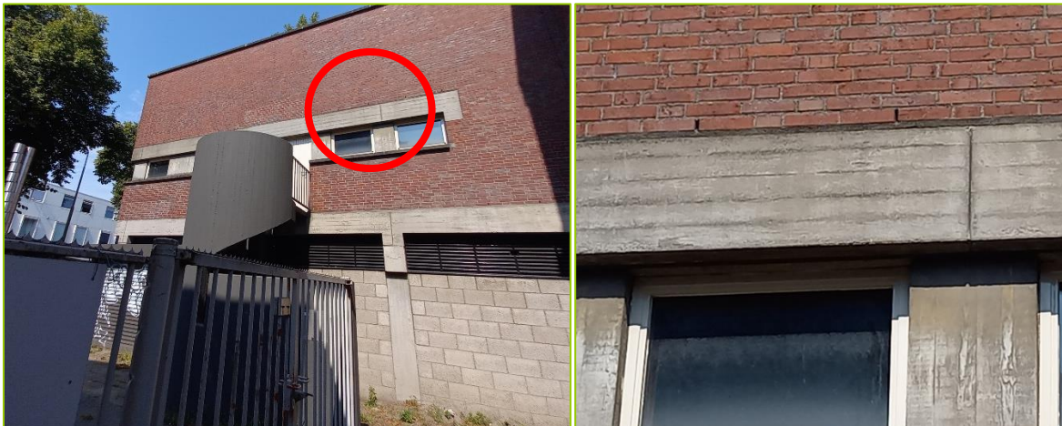
Figuur 2 In het westelijke gedeelte van de bebouwing zijn diverse open stootvoegen aangetroffen, die mogelijk toegang bieden tot voor vleermuizen geschikte achterliggende holle ruimten.
