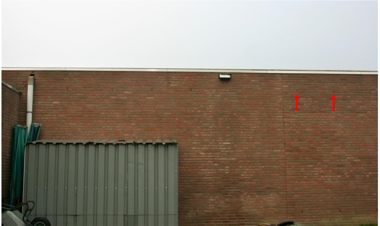
Figuur 4.4.2. In de spouwen bevinden zich meerdere open stootvoegen (hier is een gedeelte van een gevel weergegeven met rode pijlen). Hierdoor hebben vleermuizen toegang tot de achterliggende spouw.
